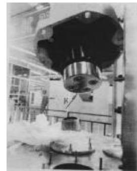
图 13 被电弧烧(熏)黑的母线触头端部
